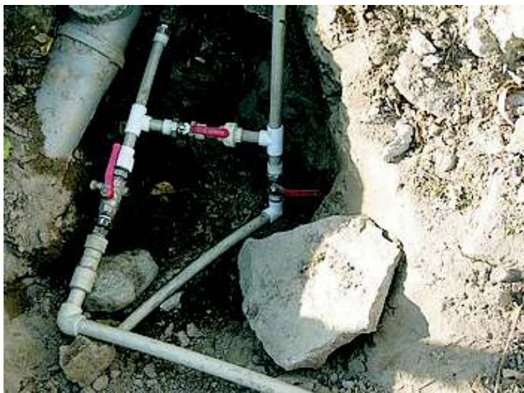
Napojení solárního systému na nemocnici
