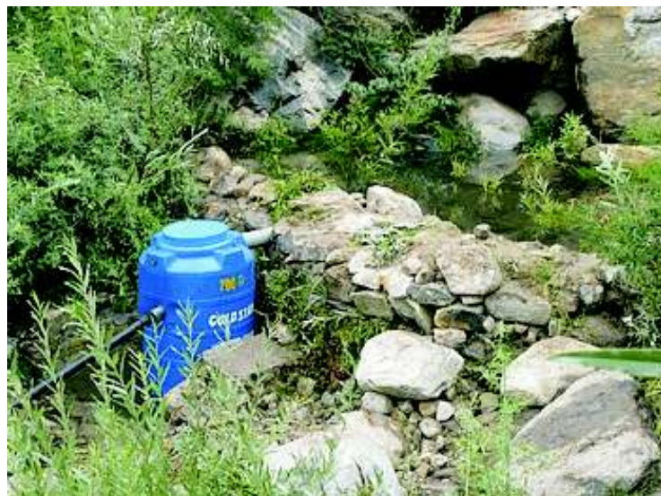
Napojení čistícího tanku. Stabilizuje i tlak vody
