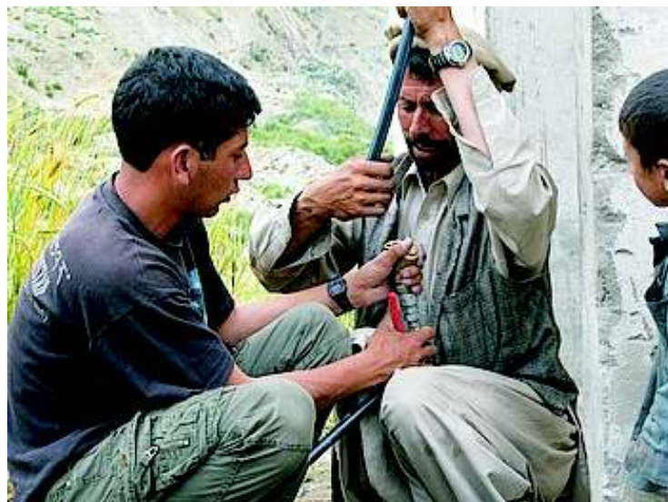
Napojení vody do solárního systému pro veřejné sprchy
